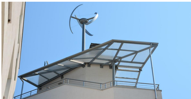
Dettaglio dell'impianto mini-eolico presente nel complesso.
